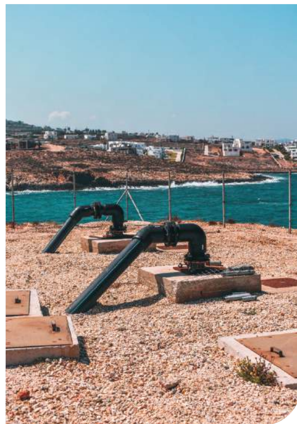
Μονάδα αφαλάτωσης Πάρου
